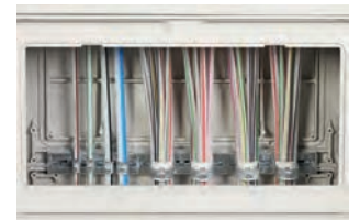
▲ Sockel mit geöffneter Klappe und montierten Mikrorohren
