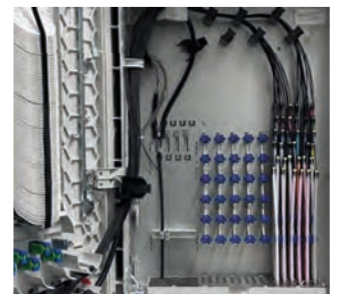
▲ Zu- und Abgangsbereich der Mikrorohre im Gehäuse rechts mit Faserüberführung links
